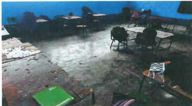
Foto 1: Piso deteriorado del módulo 1, 2, 3 y 4, se pondrá piso cerámico.
