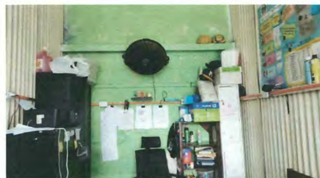
Foto 4: Segunda pared deteriorada y sin repellar una gran parte del Módulo 4..
