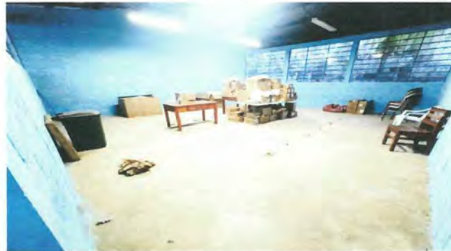
Foto 2: Piso deteriorado del módulo 1, 2, 3 y 4, se pondrá piso cerámico.
